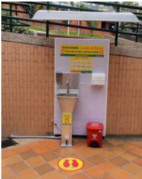
Figura 1. Puntos de lavado de manos ubicados en las zonas de mayor afluencia del Terminal de Transportes de Bucaramanga
